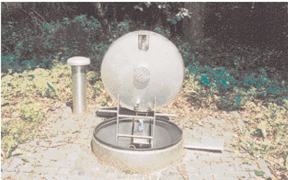
Mit Objektsicherung ausgestatteter Schacht (Abb. 2)
